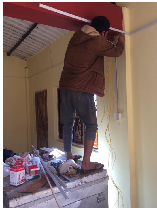
Électricité fournie par le panneau solaire
